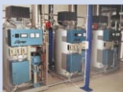
de MEERVOUDIGE-STOOM-INSTALLATIE MDA
