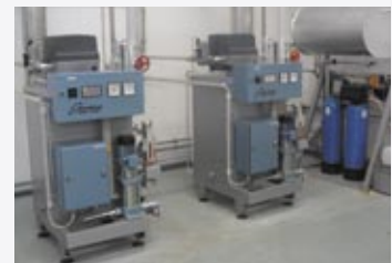
MEERVOUDIGE INSTALLATIES MDA Stoomcapaciteit: 400-1080 kg/uur
