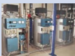
de MEERVOUDIGE-STOOM-INSTALLATIE MDA
